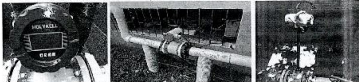
Ilustración 5. Instalación y puesta en marcha de Macro medidores
