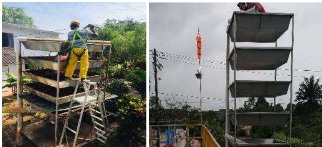
Imagen 1. Pozo 1 y 2. Sistema de aireación
