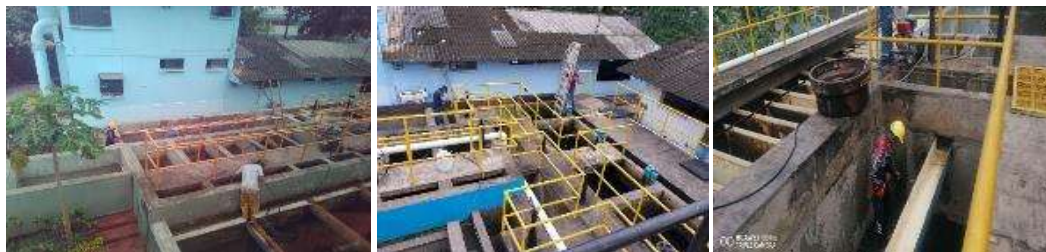
Imagen 11. Lavado de plantas de tratamiento de agua potable
