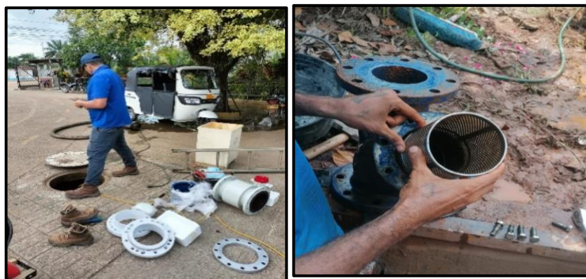
Ilustración 3. Instalación macromedidores de entrada y pozo 2
